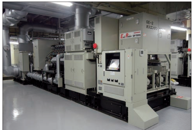
写真4 東京工科大学で稼働する2000kW規模（700kW×3台）のコージェネ装置
